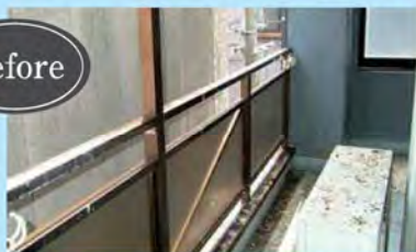
施工前。ハトの糞でバルコニーが使用不能状態。
